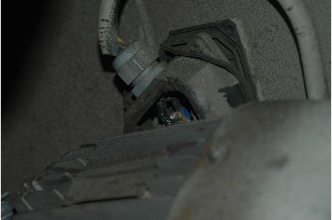
Parçalanmış olan fanın elektrik bağlantı kutusu; kararma yanma belirtisi yok, havaya uçmanın etkisi ile parçalanmış, elektrik kontağı yok.
