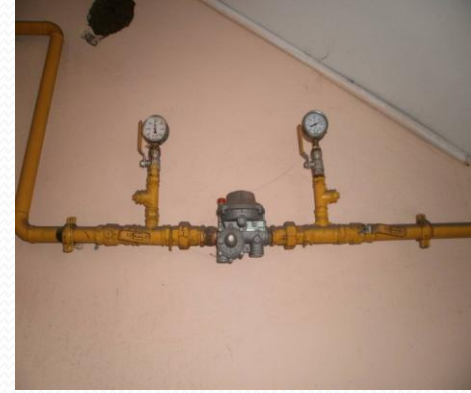
Tersanedeki doğalgaz boruları
